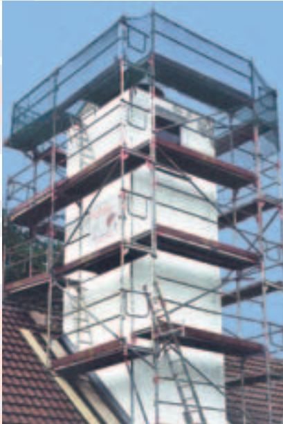
Gerüst für die Sanierung des Feuerwehrturms in Ottmaring nach den vorgeschriebenen Sicherheitsrichtlinien
